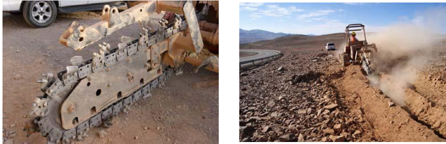
Figura 2: (Izquierda) herramienta que se utilizó para hacer la zanja donde se deposita el cable (derecha) excavación.
