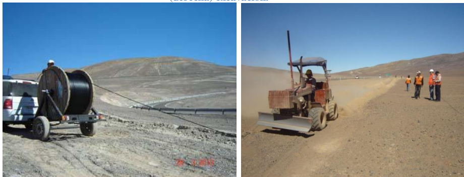
Figura 3(Izquierda) el cable se instala directamente en la zanja abierta (derecha) una máquina rellena la excavación, luego se compacta
